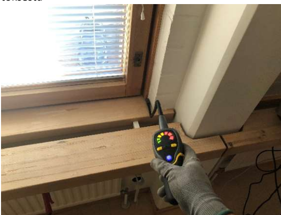
Kuva 52 Merkittävää ilmavuotoa tilan 2008 ulkoseinän ja ikkunan liitoksesta
