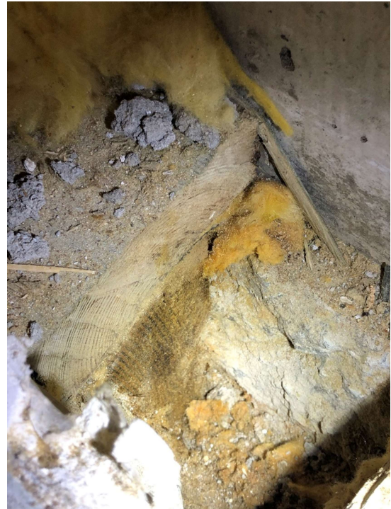
Kuva 30 RA8, sokkelihalkaisun puurunko lahonnut ja märkä
