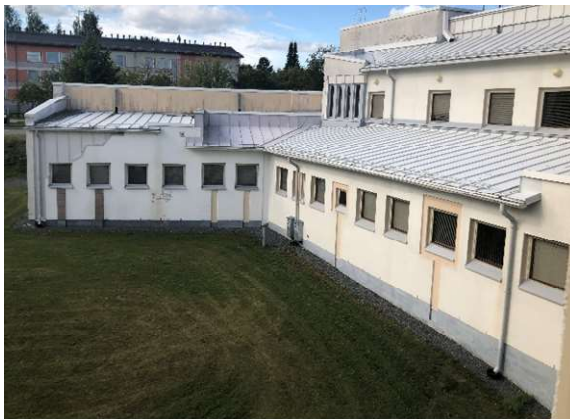
Kuva 7 Yleiskuvaa julkisivusta, julkisivu rapattu, rappauksessa runsaasti vaurioita
