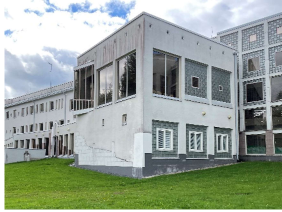
Kuva 10 Julkisivussa runsaasti vaurioita ja valumajälkiä
