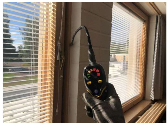
Kuva 53 Merkittävää ilmavuotoa tilan 2028 ikkunan ja ulkoseinän liitoksesta
