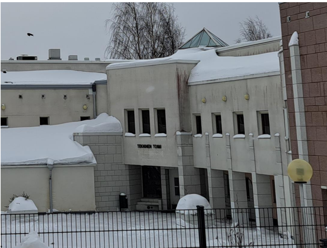
Kuva 13 Vuoden 2024 kuva (Reponen Heikki, Pieksämäen kaupunki) Kanttilan virasto-osan pääsisäänkäynnistä. Sosiaalitoimen kyltti on poistettu ja julkisivussa on havaittavissa kulumaa. Sisäänkäynnin vasemmalta puolelta on poistettu laattapintaiset koristepylväät, joiden taakse matalan osan sadevesikourut alkujaan jäivät piiloon.
