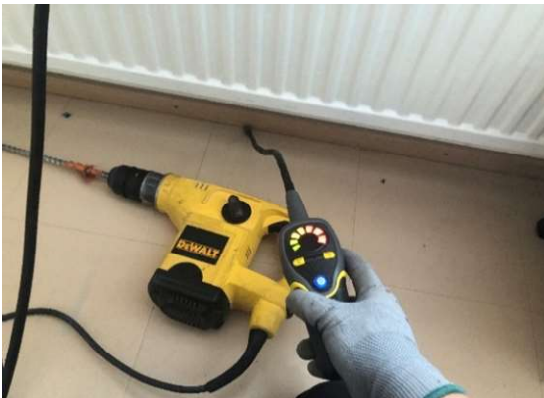
Kuva 50 Merkittävää ilmavuotoa tilan 2003 US ja VP liitoksesta
