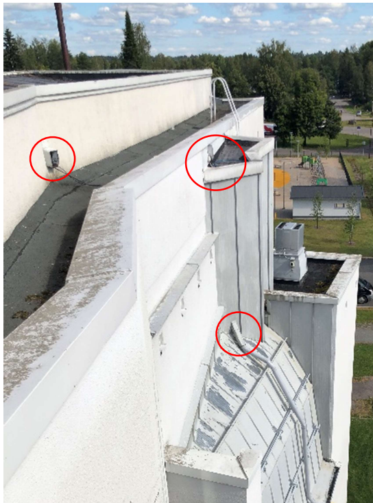
Kuva 15 Vedenpoisto toteutettu monimutkaisesti, ylempien tasojen vedet johdetaan alemmille tasoille ja syök-sytorvet kulkevat osittain rakenteiden sisällä
