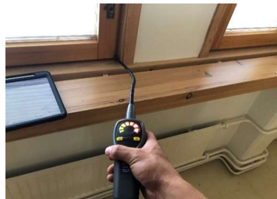
Kuva 47 Merkittävää ilmavuotoa tilan 1028 ikkunan ja ulkoseinän liitoksesta
