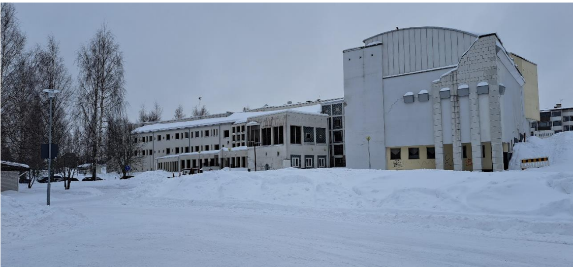
Kuva 51 Kuva Kanttilasta, 2024 (Reponen Heikki, Pieksämäen kaupunki). Kuvassa on havaittavissa useassa paikassa julkisivussa säärasituksen aiheuttamia kosmeettisia vaurioita kuten valumajälkiä ja likaa. Kuvan oikean laidan betonilaattavuorauksessa on havaittavissa likaisia valumajälkiä katolta, ja kuvan keskiosassa näkyvässä vaaleassa rappauksessa on selkeitä pinnan tummentumia. Rappaus on myös paikoitellen irtoillut seinästä, kuten esimerkiksi kuvan oikeassa laidassa näkyvästä auditoriosiiven korkeimmasta seinäelementistä on havaittavissa. Rappauksen alta näkyy paljas tiilipinta. Auditoriosiiven keltaiseen julkisivupintaan on töherrelty graffiteja. Vuoden 2018 inventoinnin jälkeen kuvan oikeassa laidassa sijainneet portaat on purettu rakennuksen luoteispäädystä. Portaiden paikalle on rakennettu väliaikaiset kaiteettomat rappuset, jotka ovat kuvanottohetkellä hangen alla. Portaiden ylä- ja alapäässä on väliaikainen työmaa-aita.
