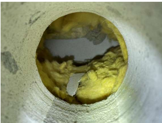
Kuva 34 RA11, lämmöneristeenä mineraalivillaa, tuuletusrako puuttuu
