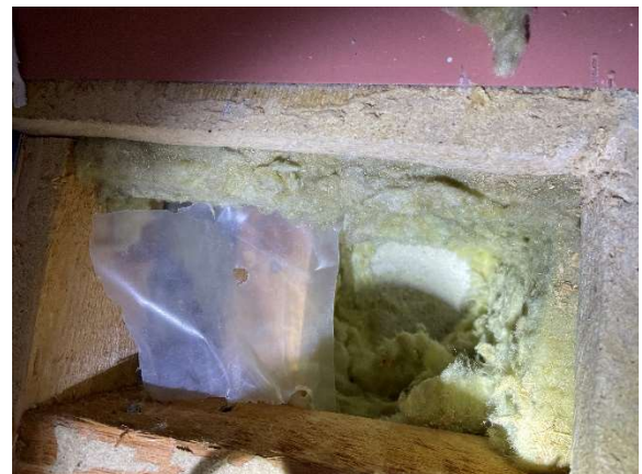
Kuva 26 RA7, mineraalivillan alla betonilaatta
