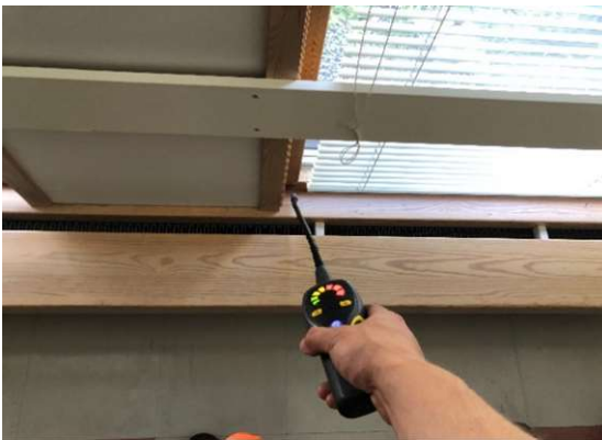
Kuva 44 Merkittävää ilmavuotoa tilan 0044 karmiliitoksesta
