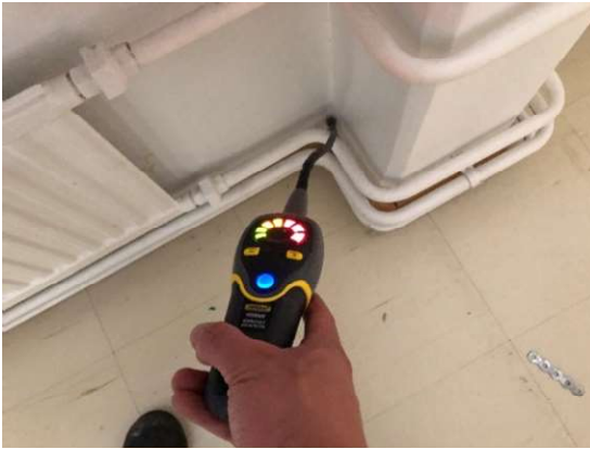
Kuva 48 Merkittävää ilmavuotoa tilan 1028 pilarin ja ulkoseinän sekä alapohjan ja ulkoseinän liitoksesta
