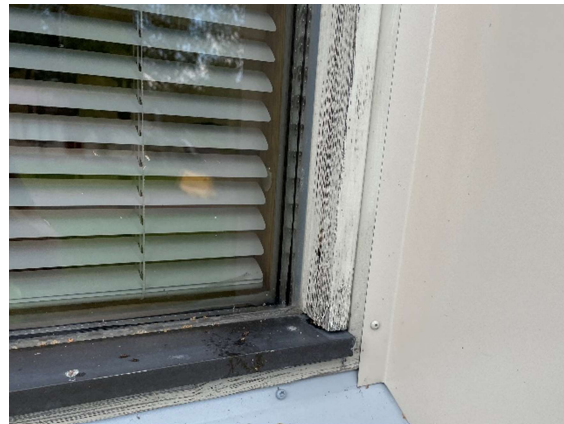
Kuva 12 Puuikkunat pääosin MSE-ikkunoita, ulkopuolen maalipinta huonossa kunnossa
