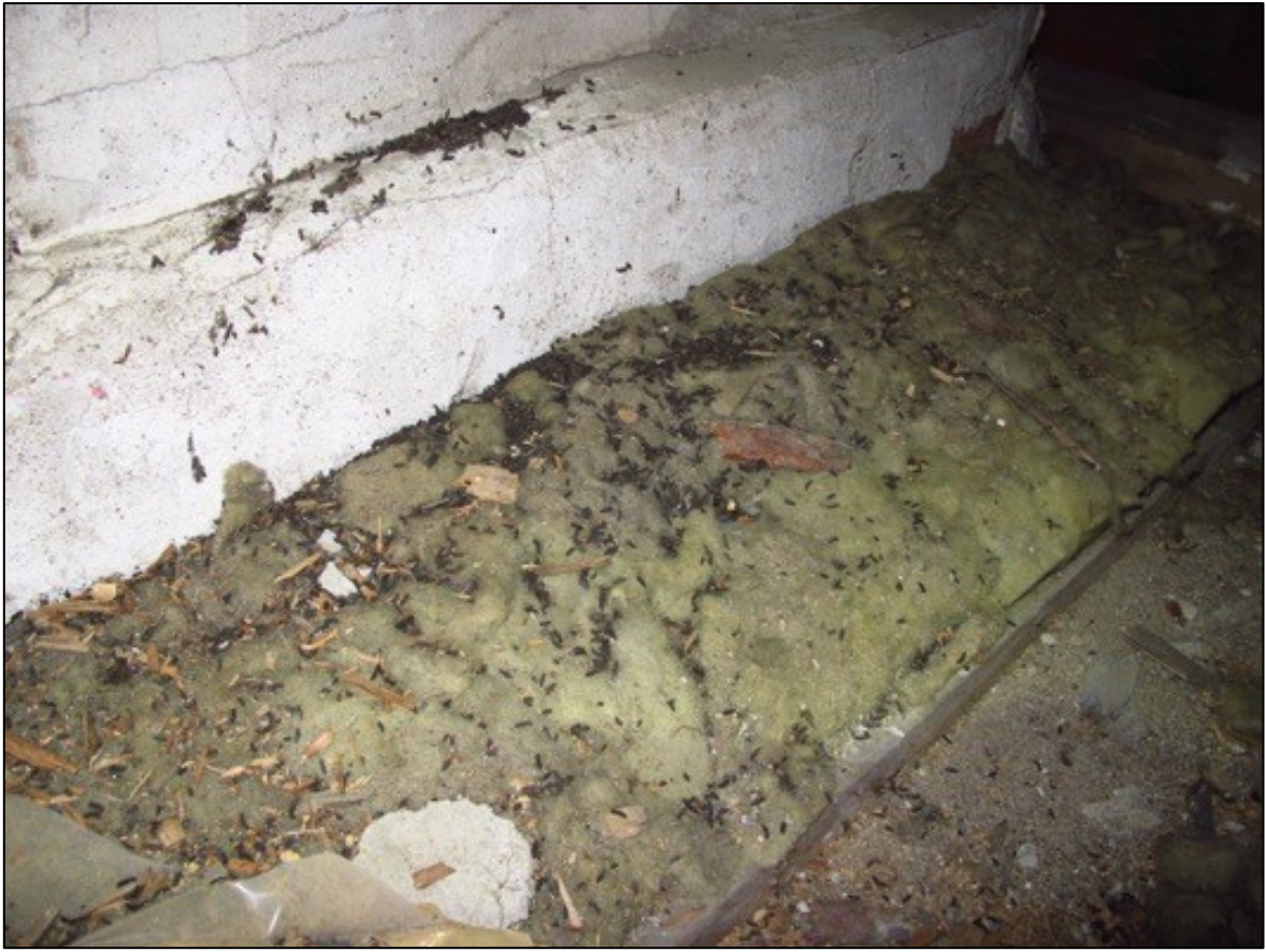
Kuva 23. Lahnasentie 190:n saunan yläpohjatilassa oli runsaasti lepakoiden papanoita.
